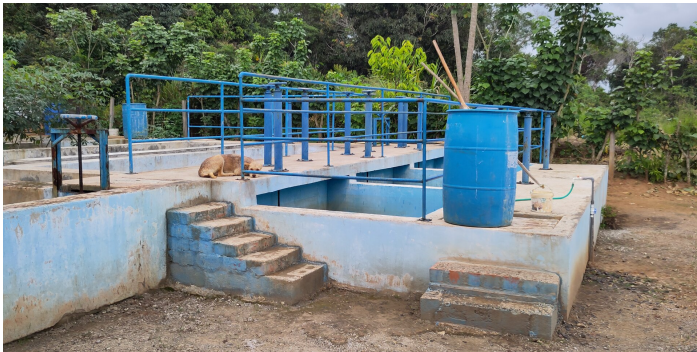
Trinkwasseraufbereitungsanlage in San Martín
