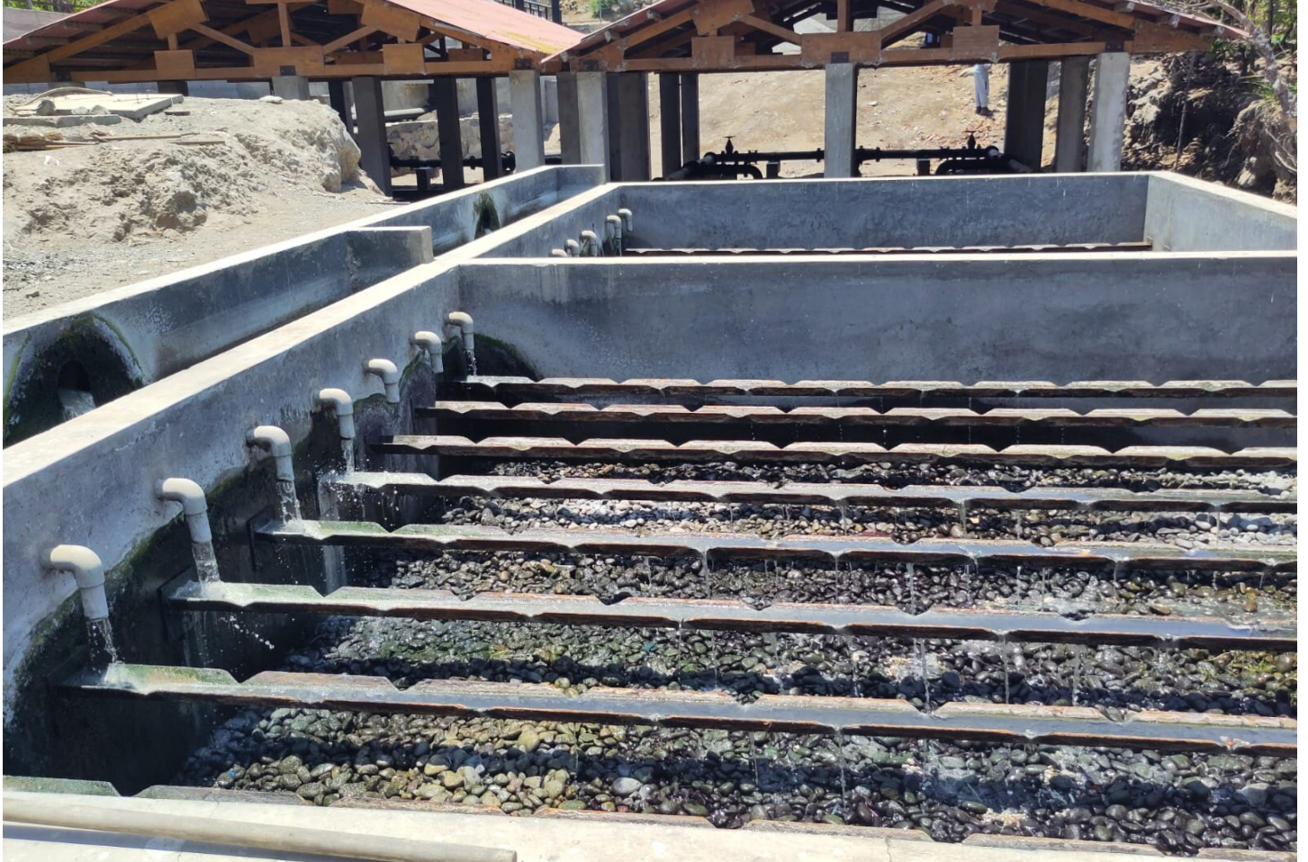
Biofilter nach einem Tanque Imhoff (Kläranlage von Lunahuana)
