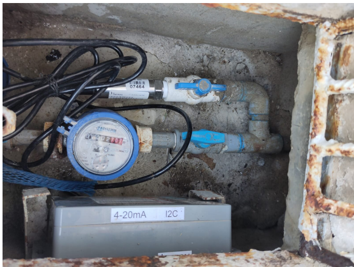
Schacht mit Datenlogger bei einem Hausanschluss
